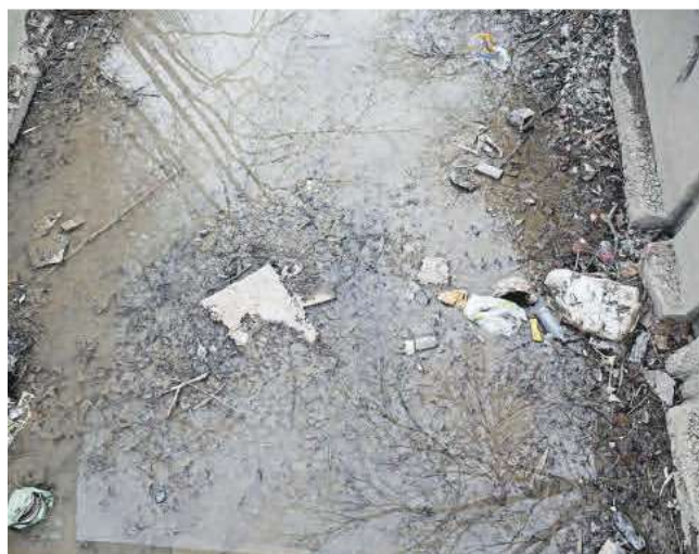
Basura acumulada en el cauce del Canal Imperial a su paso por Torrero.
